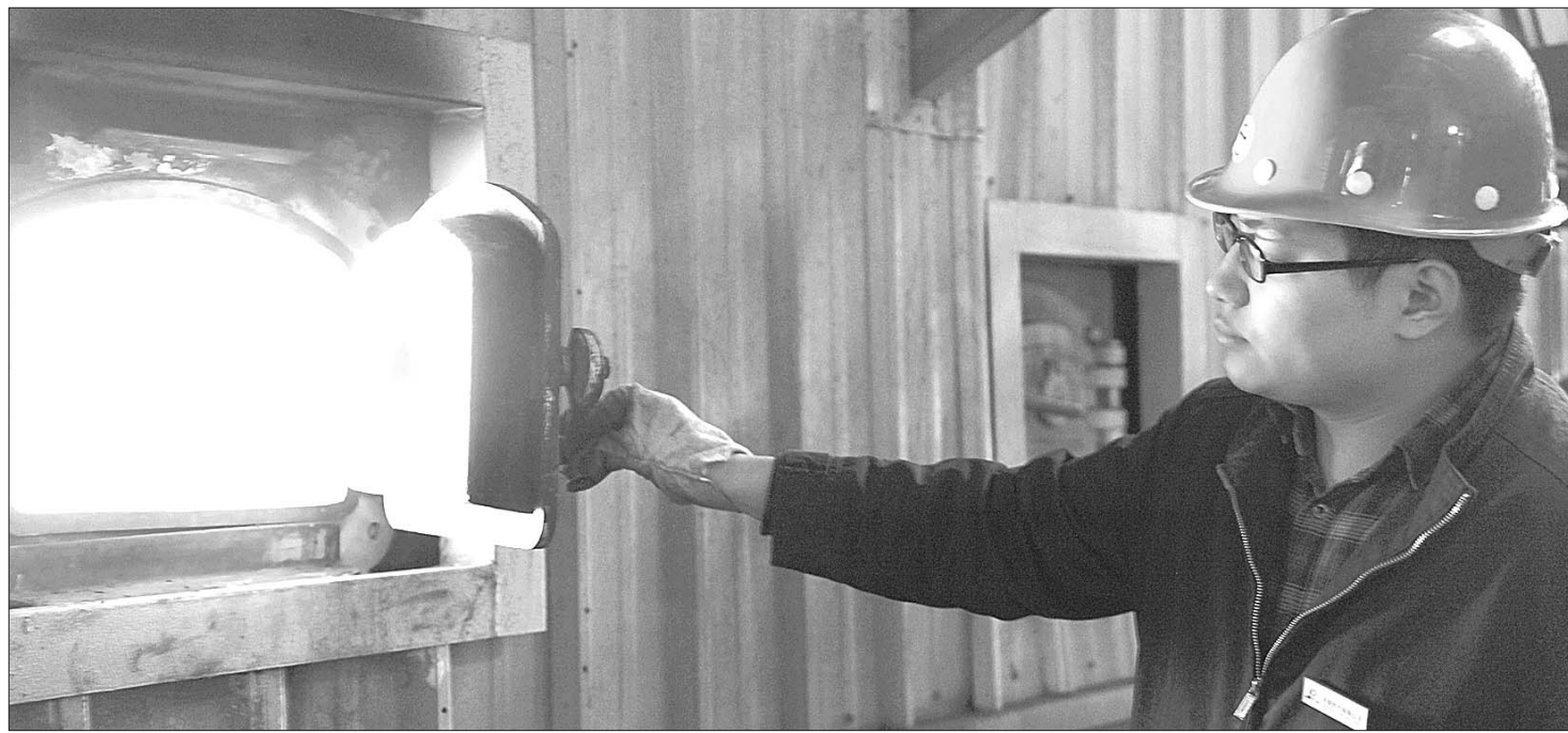
14日,浆水泉热源厂锅炉火苗烧得正旺,一次网供水温度已达90℃。
