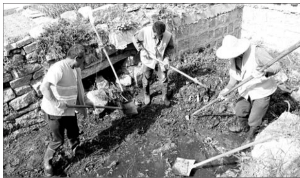
马家庄的这处明沟,一些地方需要人工下去清理。
