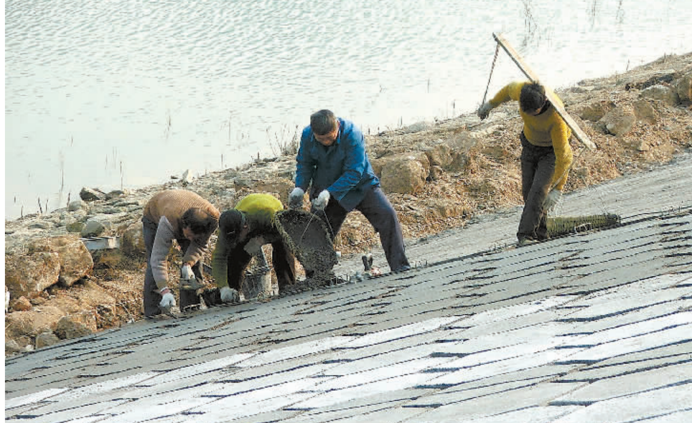
1月16日,施工人员在湘阴县燎原水库进行除险加固、灌浆防渗施工。始建于1976年的燎原水库,病险隐患多,今年该县投资750万元进行除险加固,工程预计2月底可竣工。张洪波 张国良 摄
