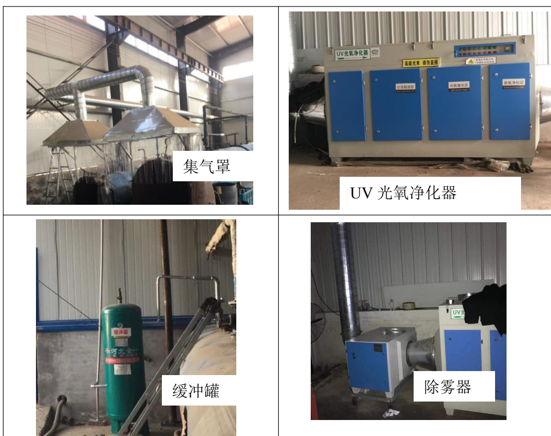
图 4-1 集气罩及废气处理设施
