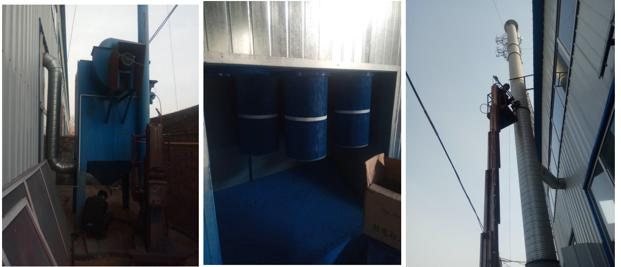
图4-1 废气处理设施
