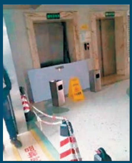
被撞壞的的電梯（左）現已停止使用。
