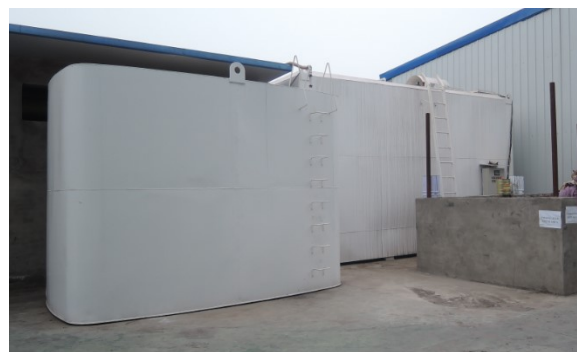
川广 35\text{m}^3/\text{d} 二级生化污水处理设施
