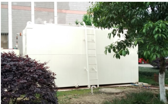
川广 25\text{m}^3/\text{d} 二级生化污水处理设施
