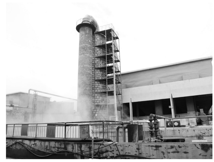
图为江西新金叶实业有限公司改造后的脱硫塔。
