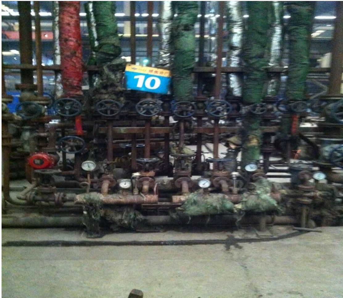
图 5-6 现场阀门照片
