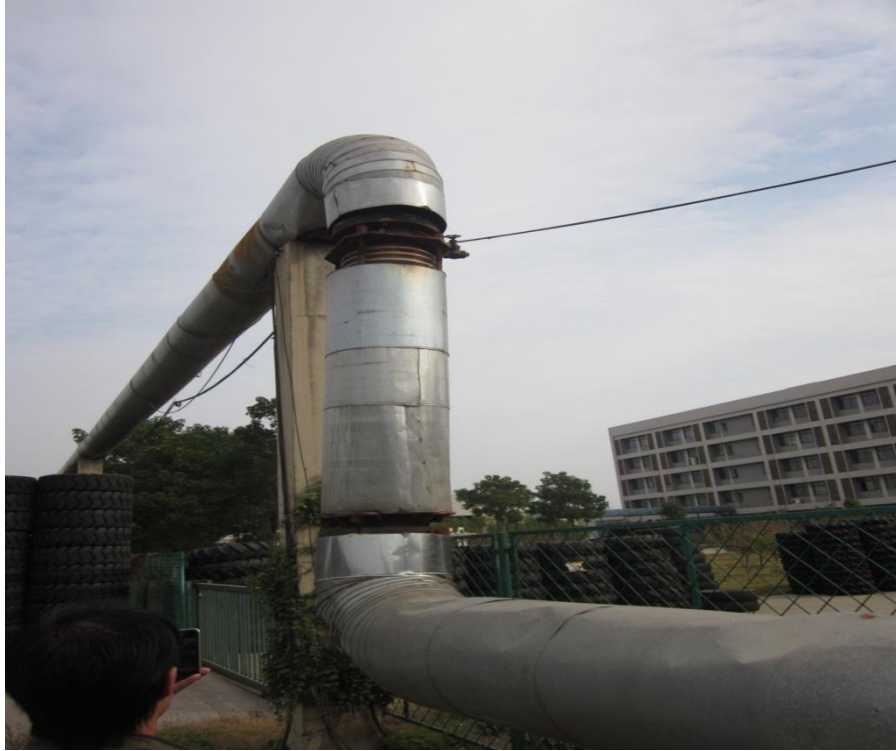
图 5-2 蒸汽管网现场图
