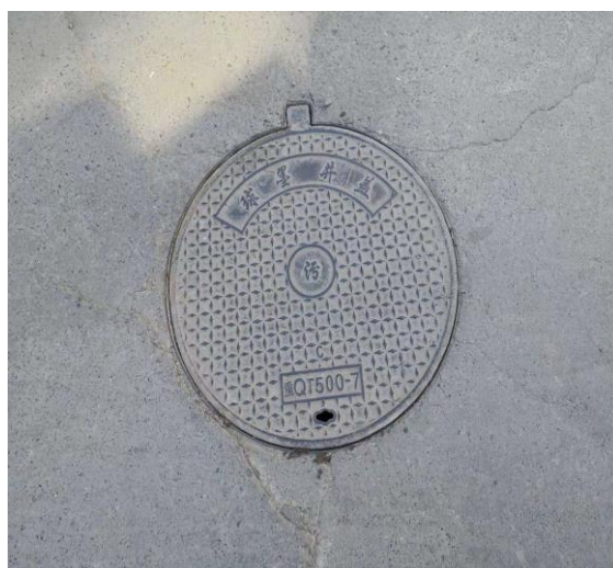
图 4 污水总排放口
