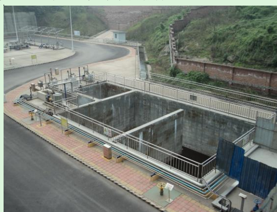
收集池作为事故池
