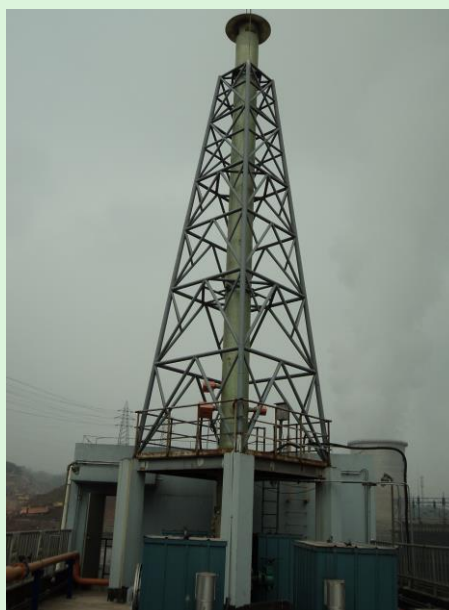
废气排气筒（25m）
