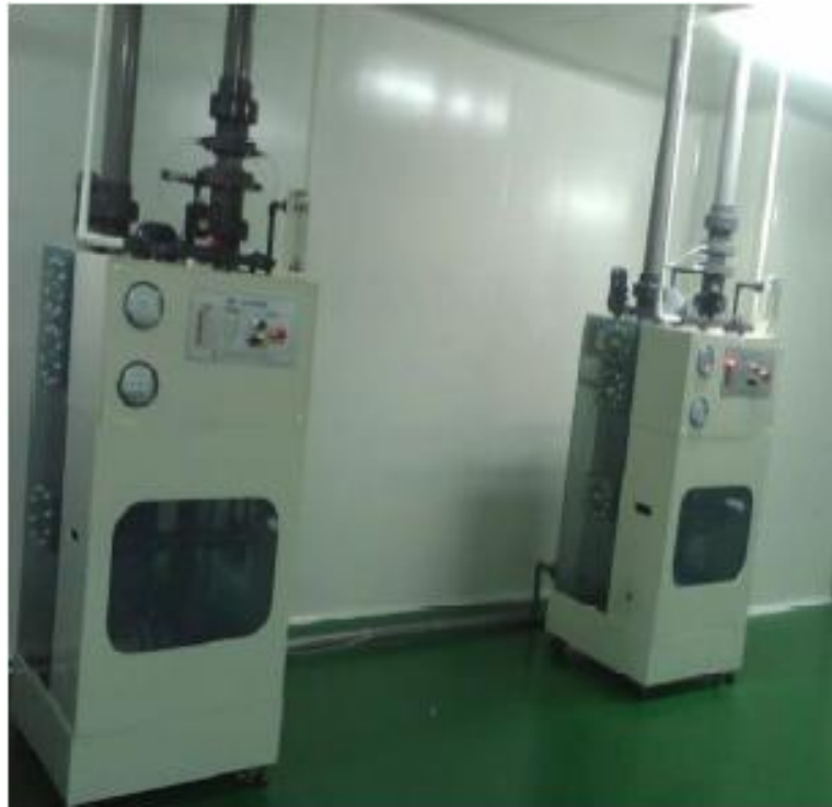
图 8-9 本项目拟采用的等离子燃烧水洗式废气处理器
