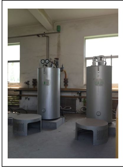
现状液化气站内管道及设备
