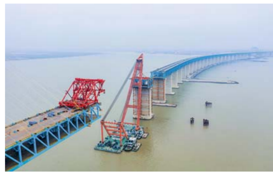
1月29日,沪通长江大桥27号辅助墩第3段节间钢梁吊装对接成功,标志着主航道桥墩顶钢梁架设施工全部完成。 新华社发
