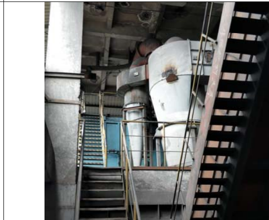
细粒钛精矿包装废气治理措施（布袋除尘）
