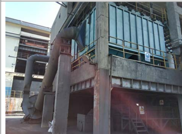
细粒干燥废气治理措施（其中的布袋除尘器）
