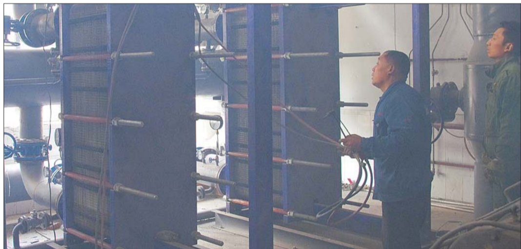
燕山供热站内新加的换热器。
