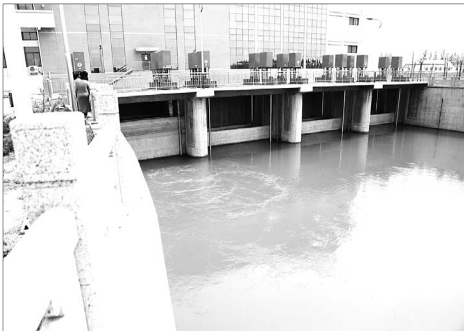
南水北调工程长沟泵站1号机正在调水。
