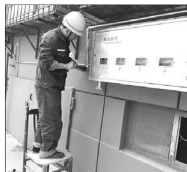
樱花园小区,工作人员安装墙外燃气管道。 本报记者 庄子帆 摄
