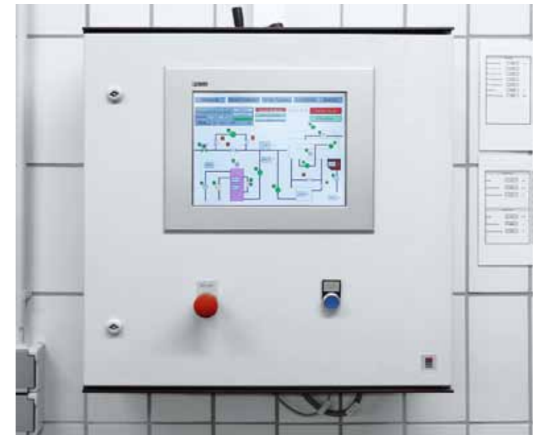
各子站直接安装有控制和监控系统设备的触摸屏
