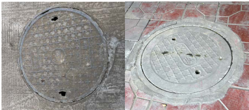
图 1-4 项目雨水、污水排污口
