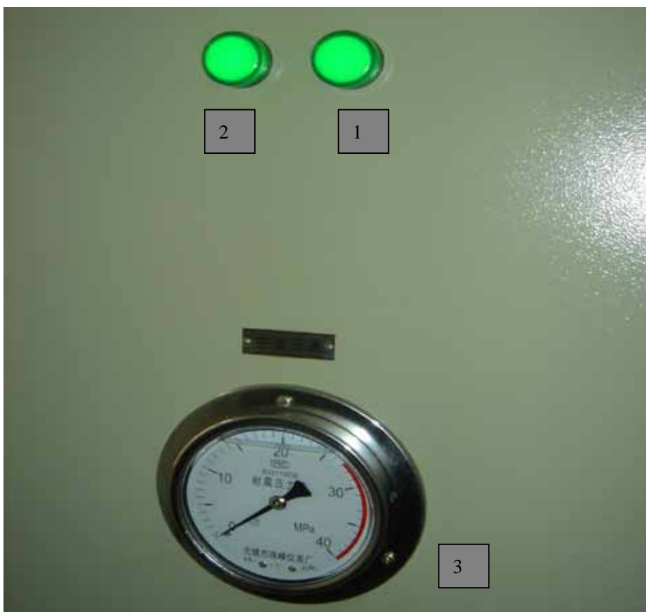
(a) 主体设备左侧面板左半部分示图
