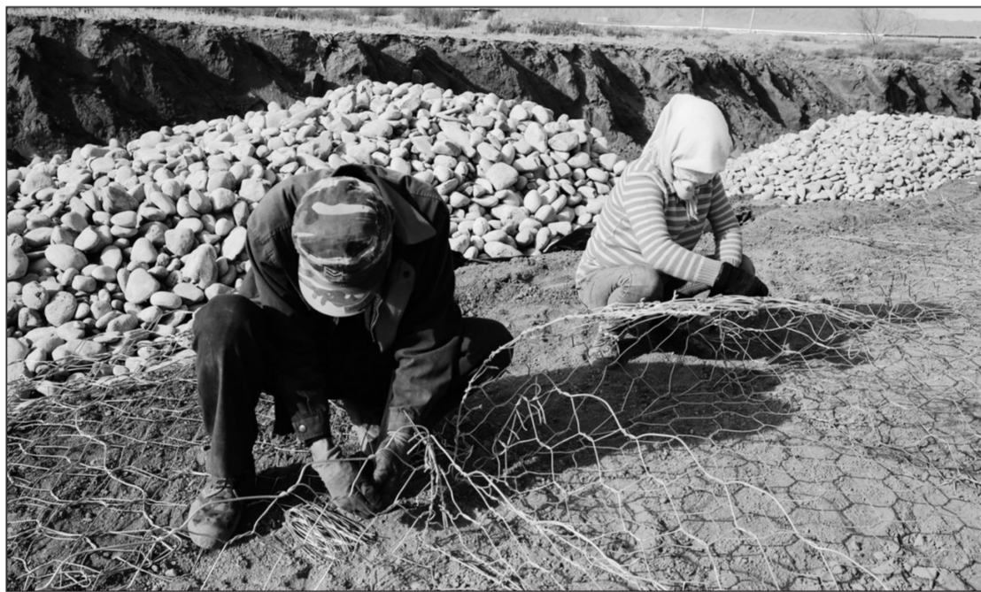
甘肃省张掖市近年来不断强化生态环境治理,实施祁连山(黑河流域)山水林田湖草生态保护修复工程,改善生态环境。图为甘州区平易河小流域生态治理项目河道整治和护岸工程施工现场。 人民图片网供图
