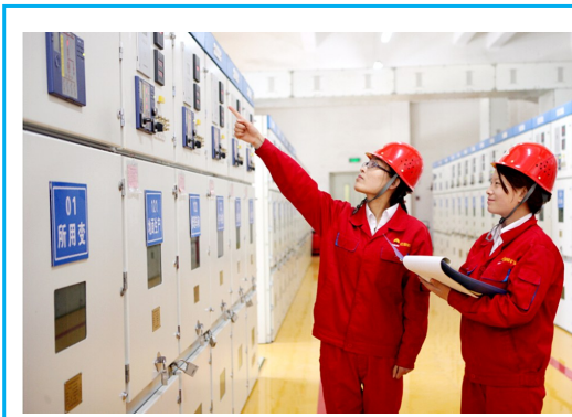
↑变电女工点检设备
